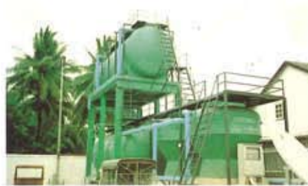
ติดตั้งยก (POWER TANK) : ศูนย์การค้า SAVE ONE ๑, นครราชสีมา
