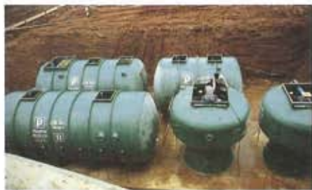
ติดตั้งลอยบนผิวน้ำ (GROUND LEVEL) : หนองพิกุล ๑, พิกุล ๒
